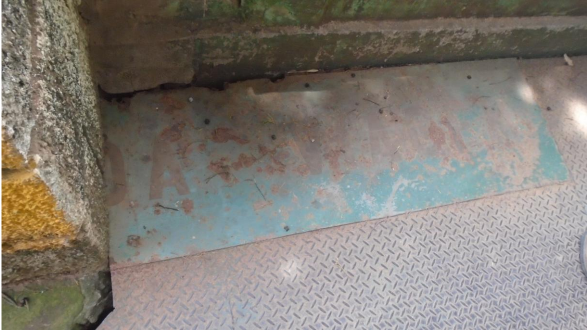
Foto 13 – Placa para cobrir buraco na passarela
