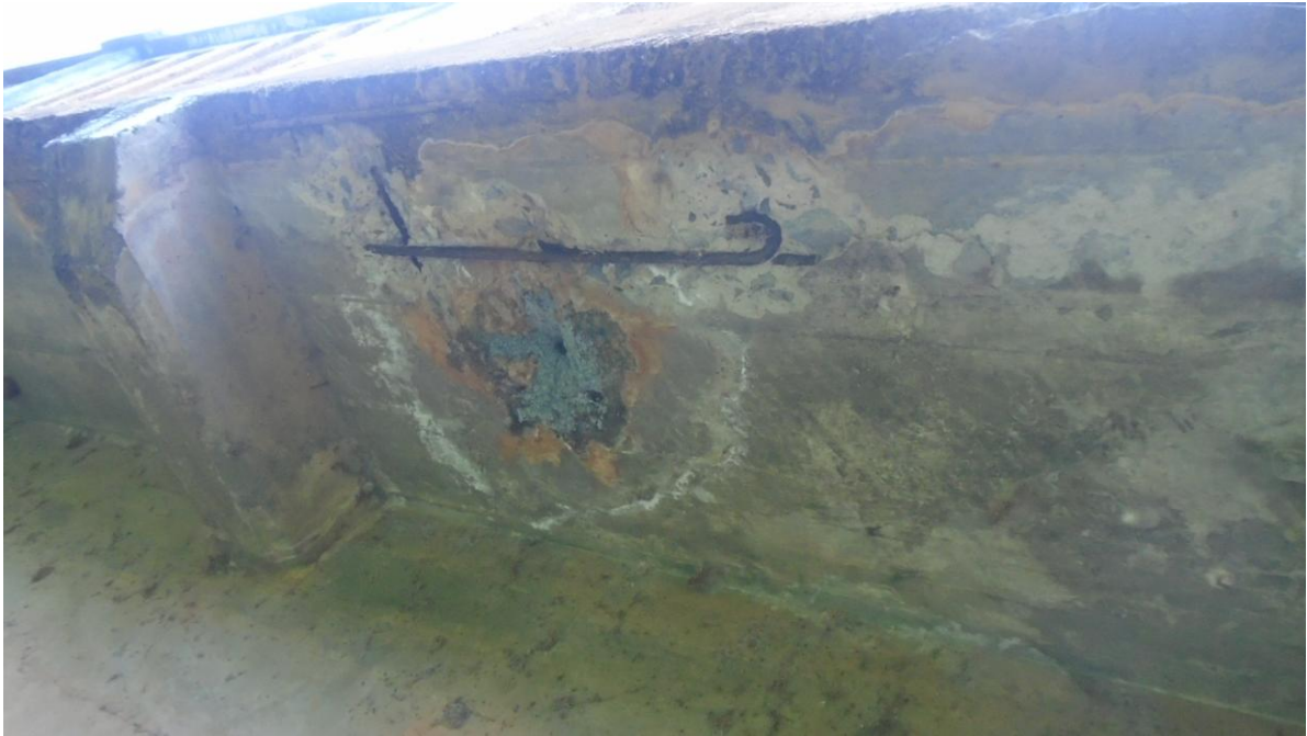
Foto 9 – Patologias na estrutura
