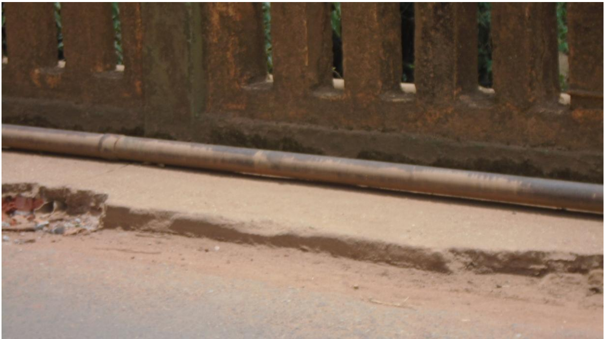
Foto 14 – Passeio interno sem aderência com a estrutura inicial
